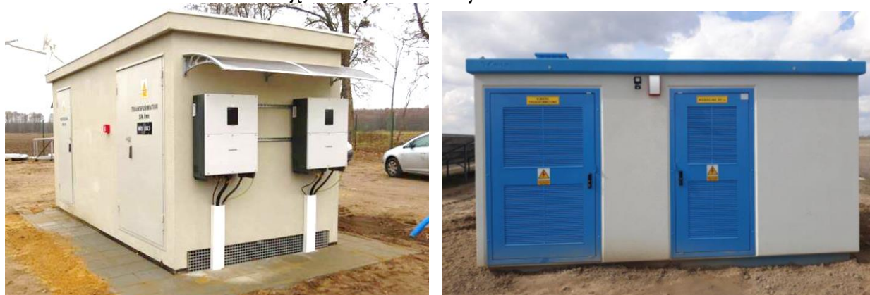
Zdjęcie8 Przykładowe stacje transformatorowe
