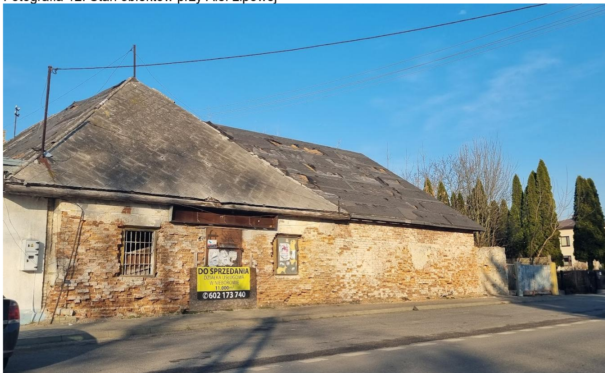
Fotografia 12. Stan obiektów przy Alei Lipowej
